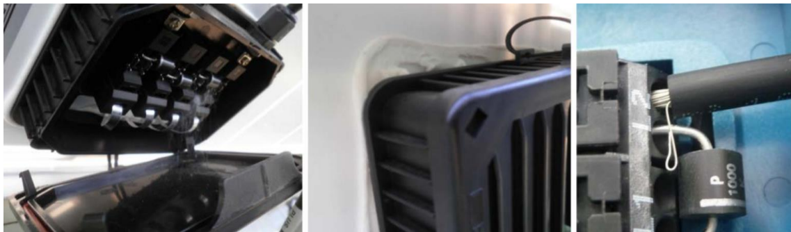
Ilustración 12: Fallos de la caja de conexiones: La foto de la derecha muestra un cableado deficiente, la foto del medio muestra una caja mal adherida en la hoja posterior y la foto de la izquierda muestra una caja de conexiones abierta en el campo. [8]
