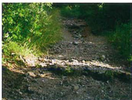
Manto superficiale naturale degradato
