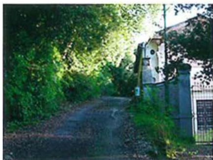
Manto superficiale improprio
