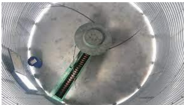
Ilustración 17 Agitador en silo
