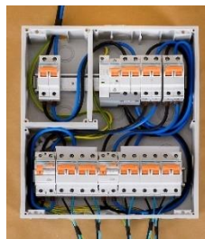
Figura 4.6. Cuadro de protecciones.
