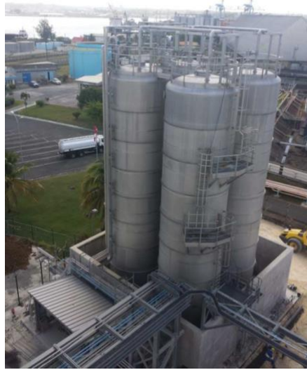
Figura 40. Vista de los tanques de almacenamiento de urea.
