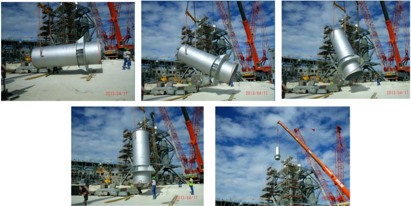
Figura 24. Vista Chimenea de Escape 2.
