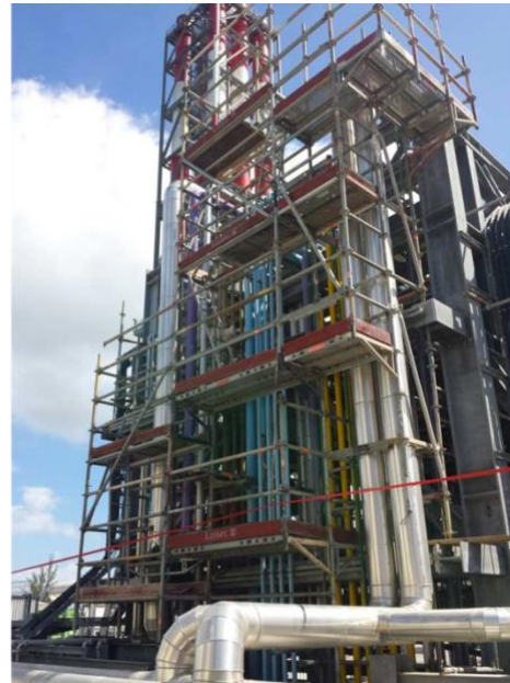
Figura 42. Vista de los estantes y caminos de tuberías 2.
