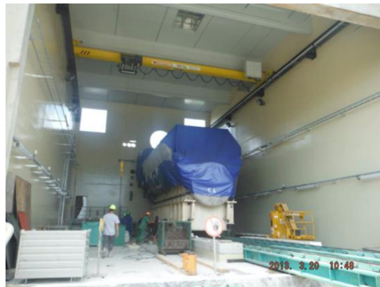
Figura 25. Vista de Equipos 1.
