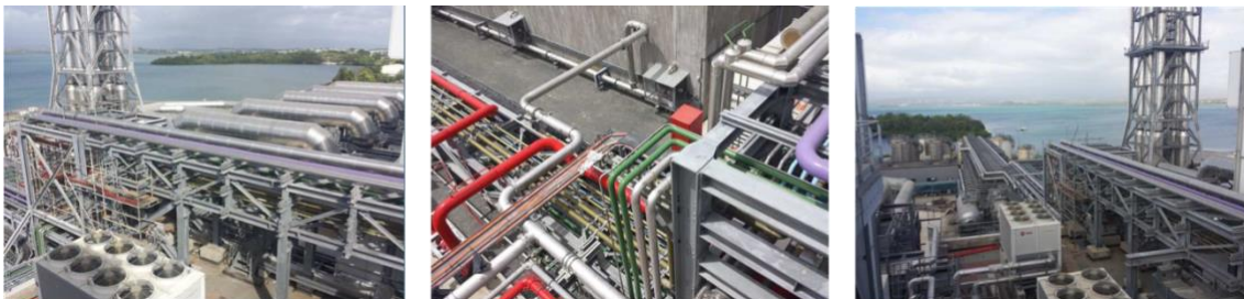
Figura 41. Vista de los estantes y caminos de tuberías 1.
