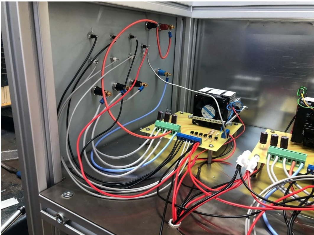
Figura 77: Detalle de conexionado de una de las placas con los bornes del bastidor. (Elaboración propia)
