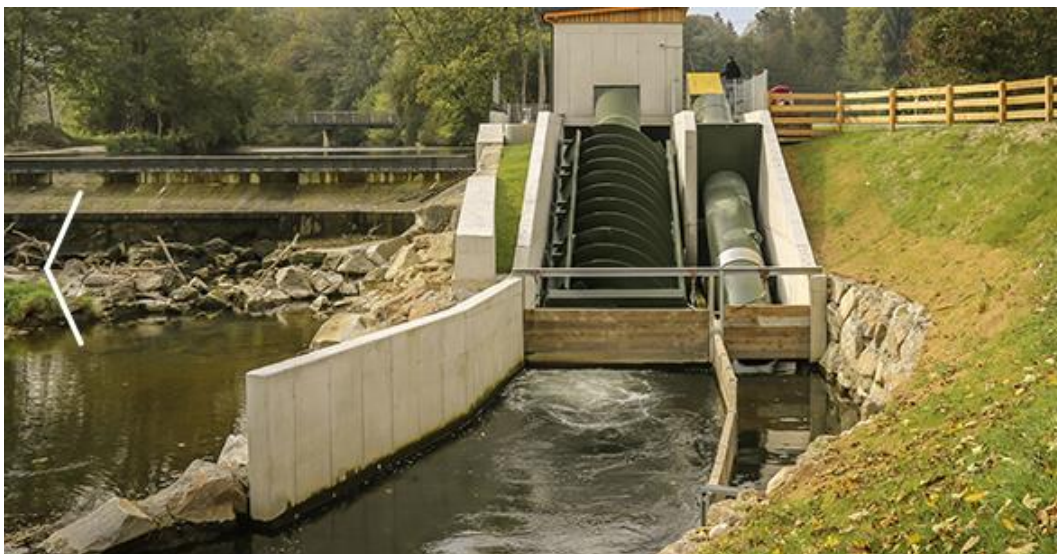
Figura 11: Central de Turbina de Tornillo de Arquímedes en Austria (Rehart Power, 2014).
