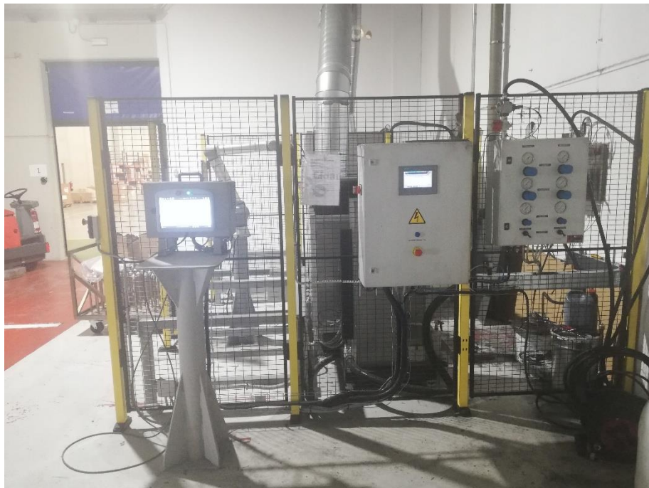
Figura 10. Zona de control de la instalación.
