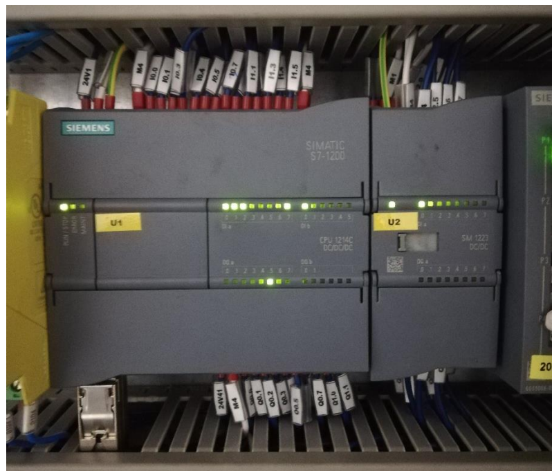
Figura 18. PLC del armario de control.
