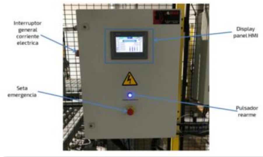
Figura 17. Armario de control.
