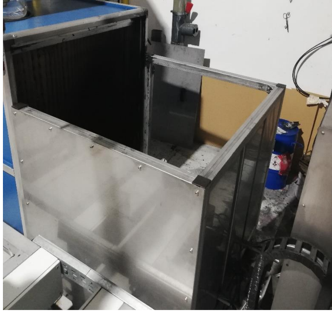
Figura 30. Cabina de pintura.
