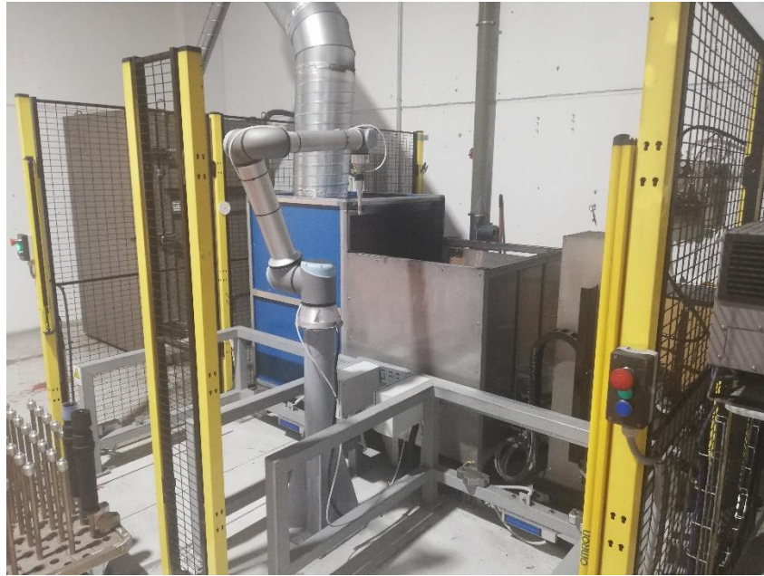
Figura 16. Ubicación del robot en la instalación.
