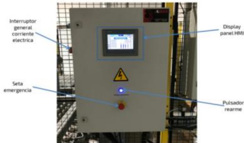
Figura 69. Armario de control.
