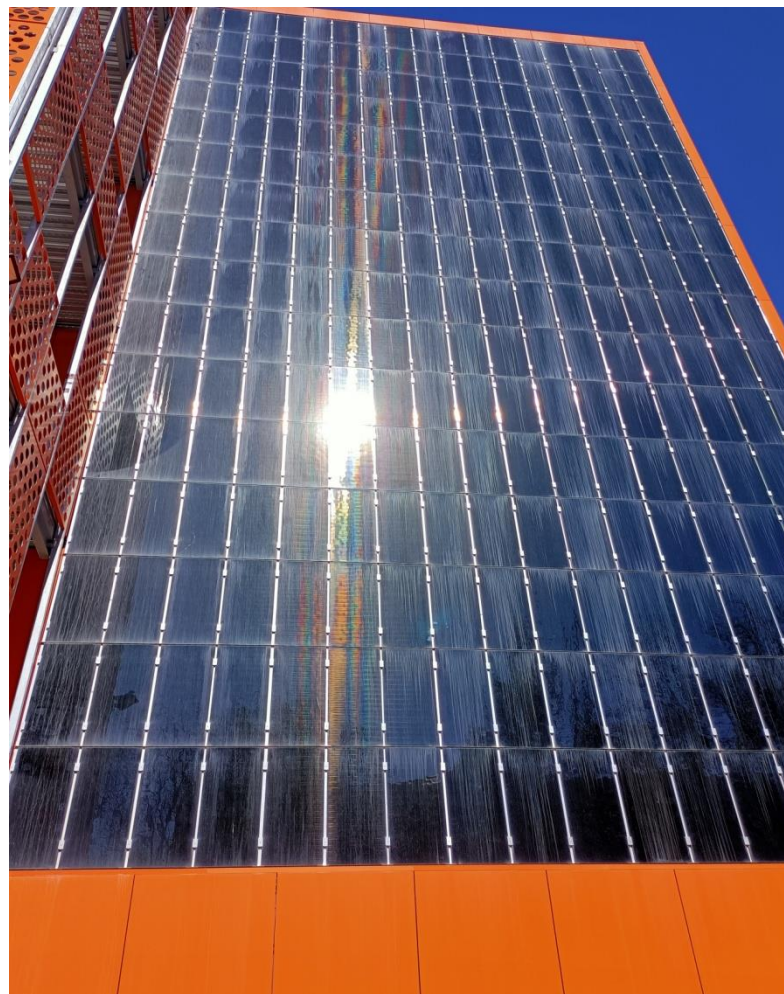
Figura 16. Placa fotovoltaica situada en la fachada sur-este del Aulario IndUva de la Universidad de Valladolid.
