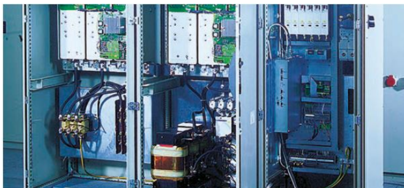
Figura 23: Armarios contenedores de los sistemas de control de un banco motor.
