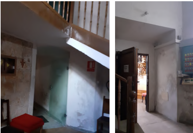
Fig. 32: Zona de vestíbulo de nueva creación y conexiones con la iglesia y el resto de dependencias. Fuente: Elaboración propia.
