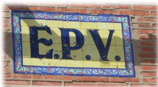
(12) Iniciales de la empresa sobre azulejo en caseta de transformación antigua y operativa en el cruce de la carretera a Santovenia. Se puede apreciar el nombre del fabricante en la esquina inferior derecha.
