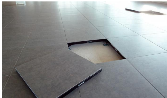
Imagen 2. Suelo técnico continuo de baldosas cerámicas.
