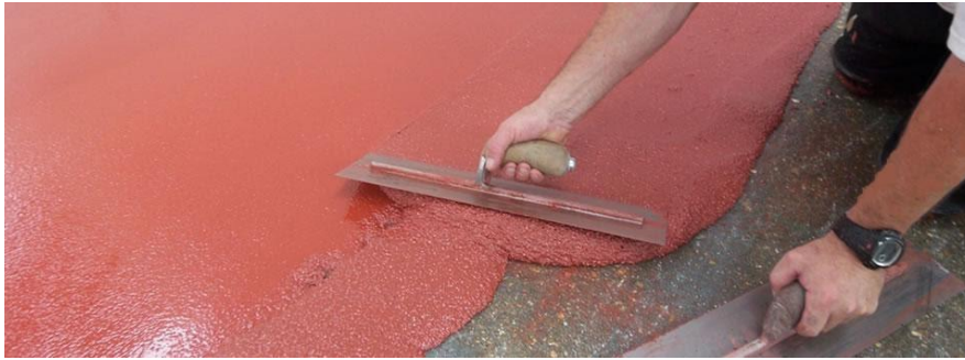
Imagen 3. Suelo continuo de resina epoxi.
