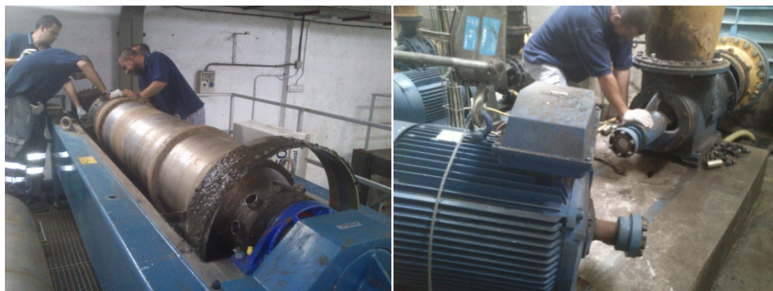
Foto 9. Desmontaje de la centrífuga para su lavado. Foto 10. Desmontaje de bomba de recirculación para su limpieza.
