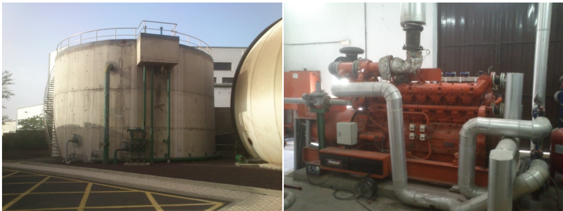
Foto 3. Digestor de fangos. Foto 4. Motor generador de electricidad mediante el empleo de biogás.
