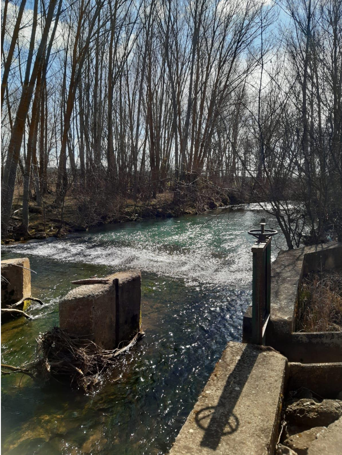
Figura 11. Azud y compuerta para riego desde la margen derecha. Fuente: Propia.
