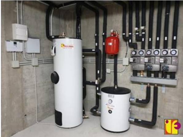
INSTALACIÓN INTERIOR DE AEROTERMIA. FUENTE: FECCJUSA
