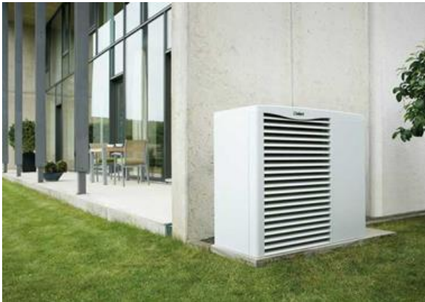
UNIDAD EXTERIOR AEROTERMIA. FUENTE: VAILLANT
