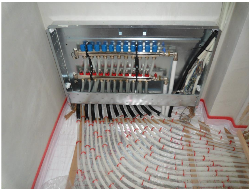
ARMARIO DE INSTALACION DE SUELO RADIANTE. FUENTE: BLOG TÉCNICAS REUNIDAS
