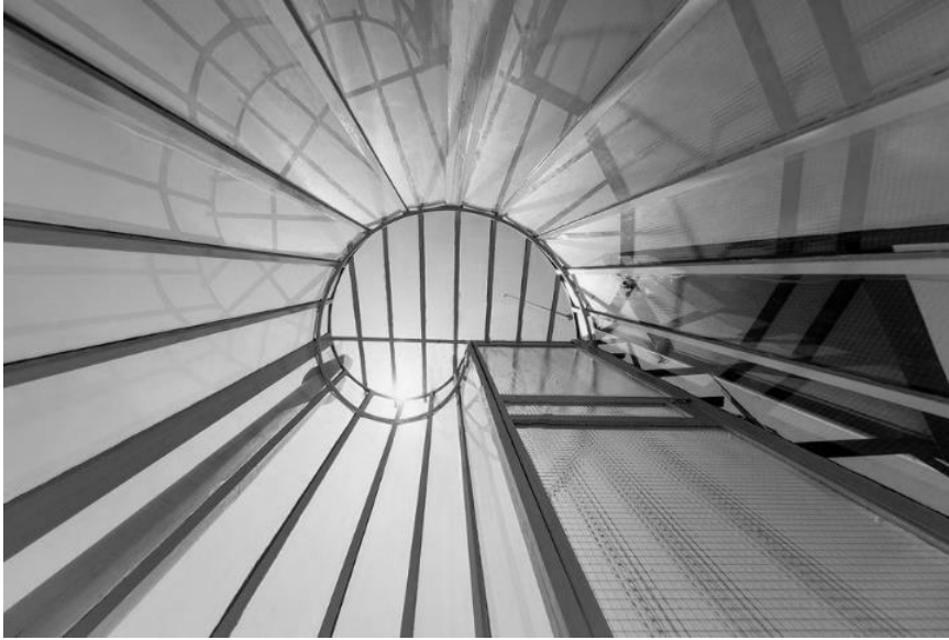
(fig. 23) Detalle de la estructura de cubierta del lucernario de las escaleras de E.1027.
