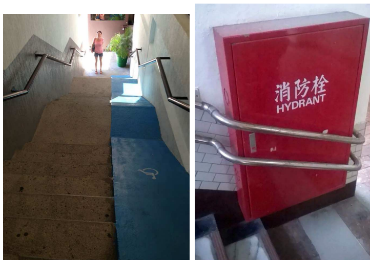
(a) Rampa para las sillas de ruedas (b) Mala ubicación de la caja contra incendios
