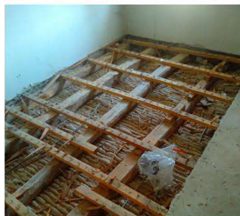
Figura 114. Imagen que muestra a su izquierda un ligero pandeo. Fuente: Foto propia
