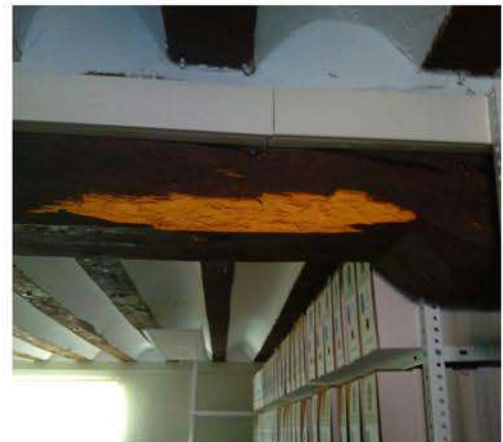
Figura 84. Imagen de la viga afectada por insectos xilófagos. Fuente: Foto propia
