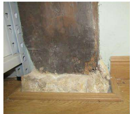
Figura 99. Pie derecho colocado al oeste donde se ve la falta de dimensión de la piedra Fuente: Foto propia
