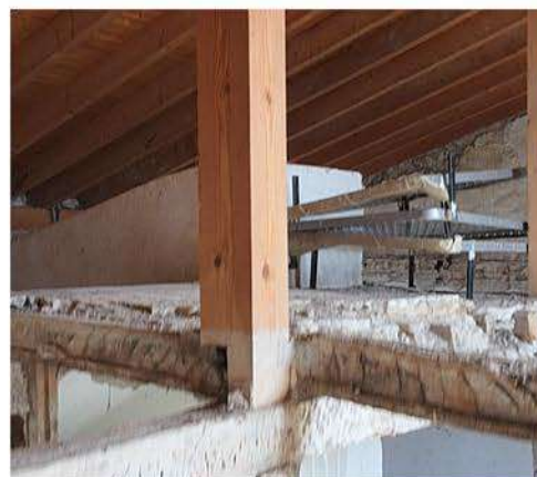
Figura 93. Imagen extraña unión entre pie dercho y forjado Fuente: Foto propia
