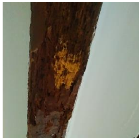
Figura 165. Imagen de una vigueta del forjado dañada.
