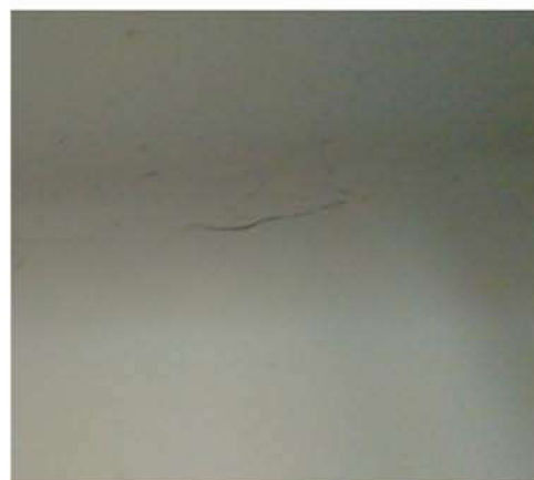
Figura 117: Imagen que muestra una fisura en la parte baja entre la unión del forjado y el muro. Fuente: Foto propia
