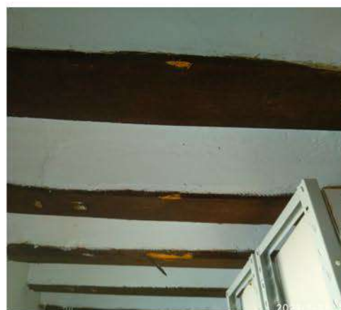
Figura 87. Imagen de viguetas de la zona noroeste atacada por insectos xilófagos. Fuente: Foto propia
