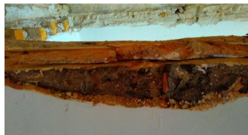
Figura 63. Imagen de viga quemada, que evidencia que hubo un incendio y se reutilizaron materiales del edificio anteriormente existente
