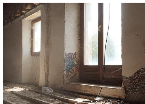
Figura 164. Imagen del estado de la carpintería exterior.
