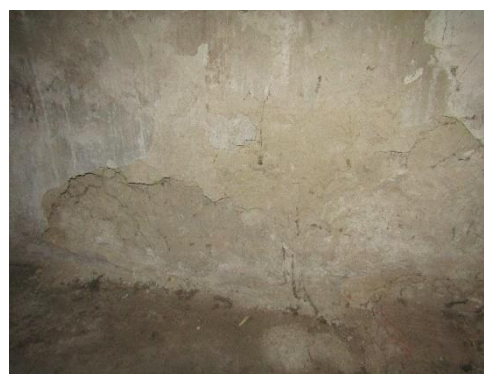
Figura 167. Imagen del arranque del muro, donde se ven problemas de capilaridad
