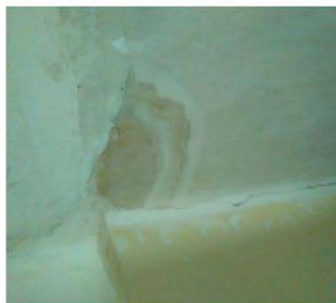
Figura 126. Imagen de la humedad en el hueco de ascensor al lado de la humedad de la esquina Fuente: Foto propia
