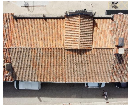
Figura 163. Imagen aérea donde se puede ver el buen estado de la cubierta. Fuente: Héctor Fernández
