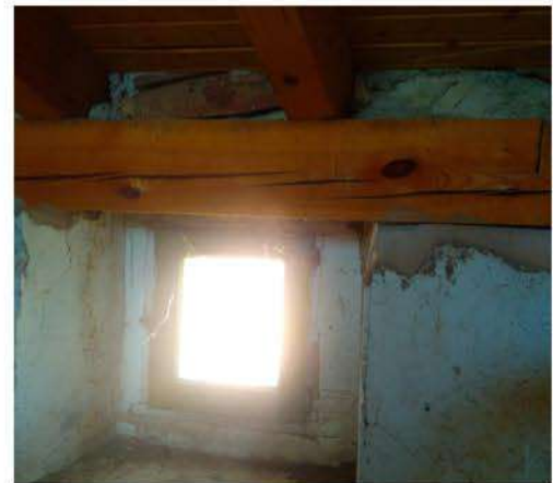
Figura 102. Imagen de la fenda que se encuentra en la viga norte antes de arranque de cubierta Fuente: Foto propia
