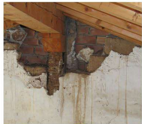
Figura 129. Imagen de la humedad en el cercano a la cumbra. Fuente: Foto propia
