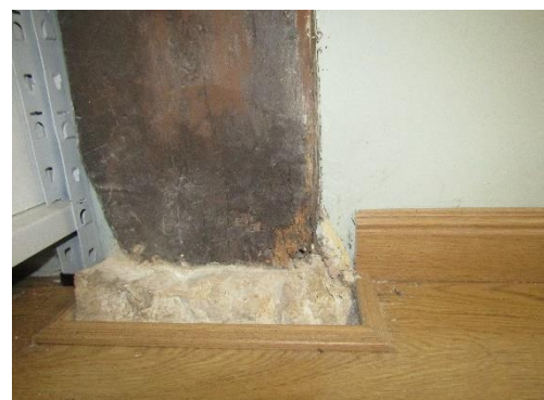
Figura 70. Hongo xilófago de pudrición parda afecta al pie derecho del edificio de estudio Fuente: Foto propia
