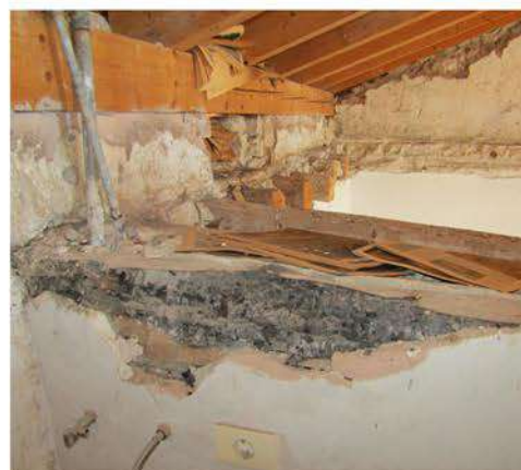
Figura 105: Imagen del brochal que se quemada, que se ve en el ultimo descansillo de la escalera. Fuente: Foto propia
