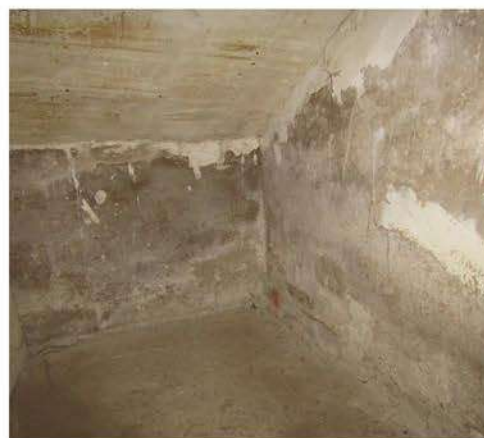
Figura 132. Imagen de la humedad que se encuentra debajo de la escalera Fuente:Foto propia
