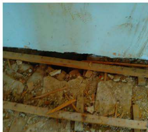
Figura 111. Imagen que señala el agujero que crea la flexión del forjado. Fuente: Foto propia
