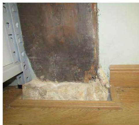
Figura 81. Imagen del arranque del pie derecho afectado por hongos xilófagos Fuente: Foto propia
