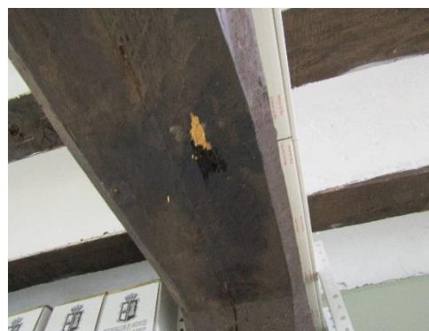
Figura 166. Imagen de la viga afectado, donde se ve el agujero creado con un elemento metálico
