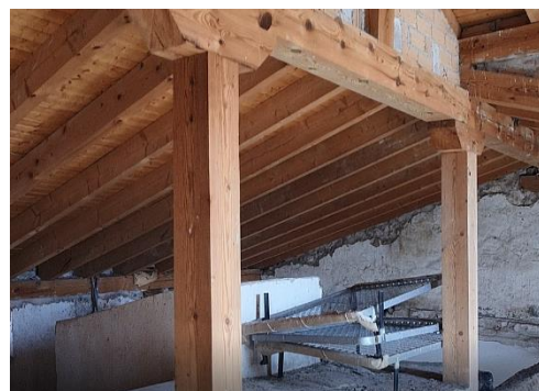
Figura 24. Estado actual de la cubierta en el interior Fuente:Hector Fernandez
