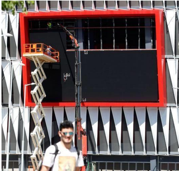
Imagen 49. Instalación de fachada multimedia de paneles opacos del Estadio de San Mamés (Bilbao, España). Fuente: https://www.deia.eus/athletic/2015/08/11/san-mames-estrenar-viernes-pantalla/450964.html
