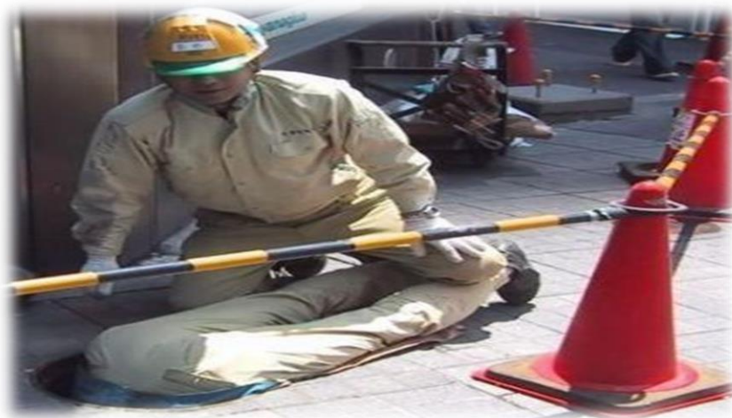
Imagen 2. Infracción de los trabajadores, se está poniendo en riesgo la vida de un trabajador.
