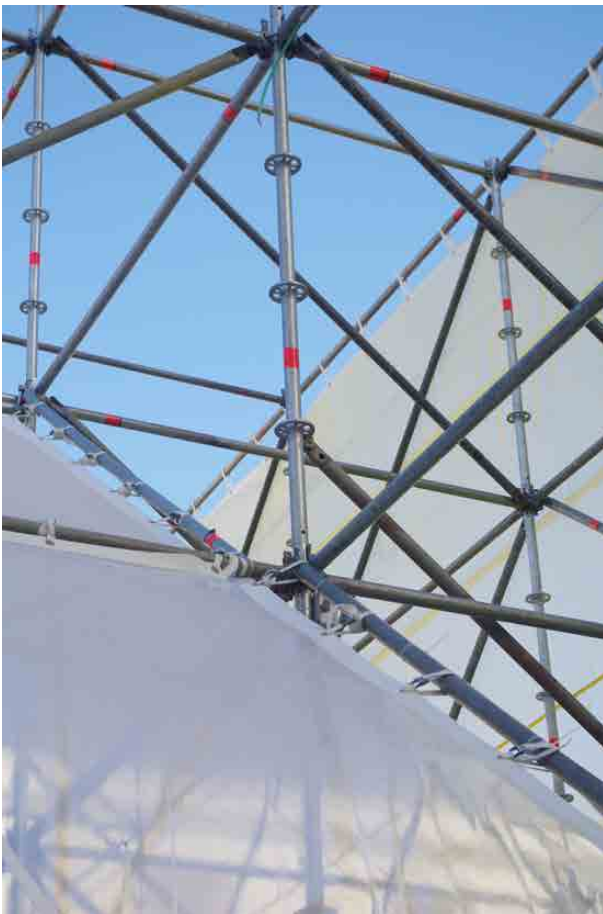
Figura 2. Detalle de la instalación. Fuente: los autores
