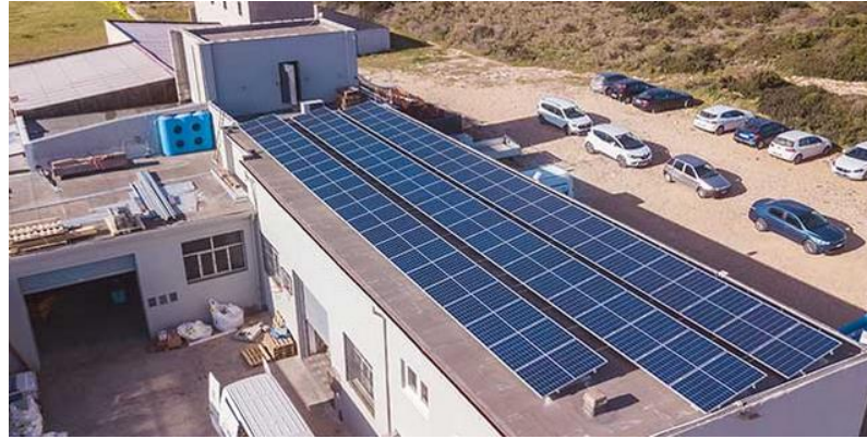
Figura 1.2- Instalación fotovoltaica acogida a compensación
