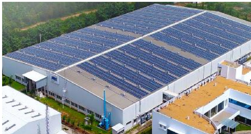
Figura 1.3 - Instalación fotovoltaica no acogida a compensación
