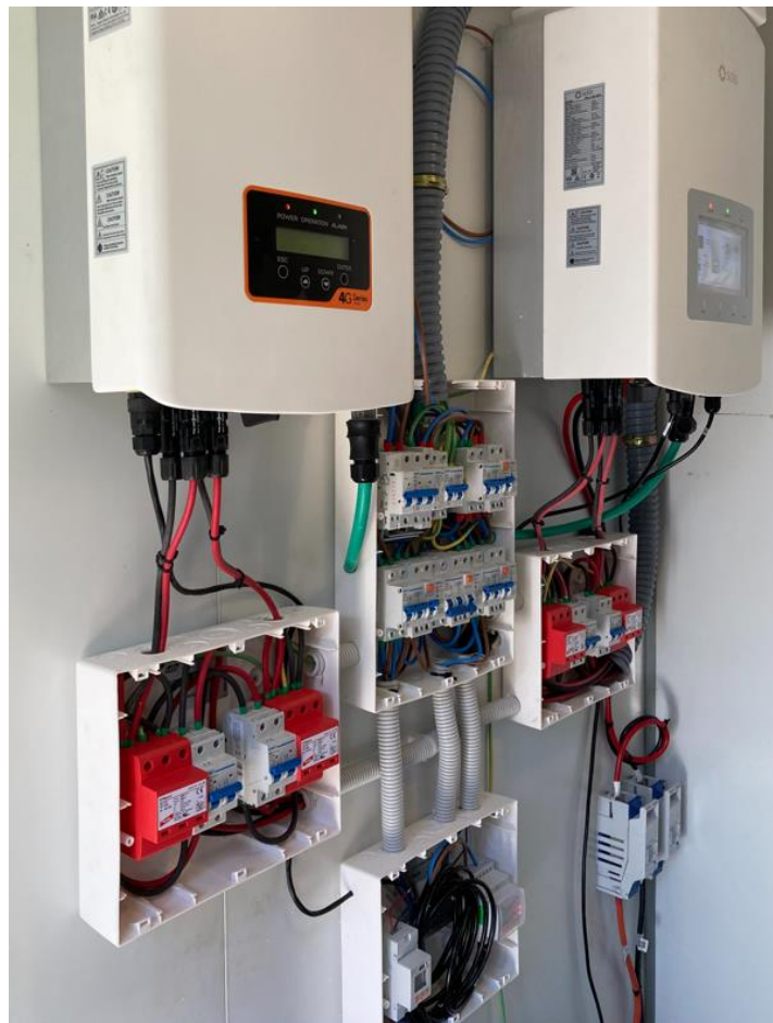
Figura 3.32- Cuadros de protecciones
