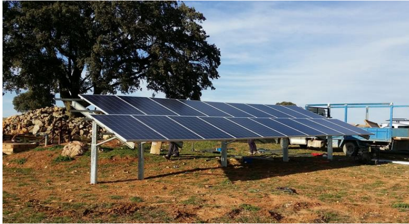
Figura 1.1- Instalación fotovoltaica aislada
