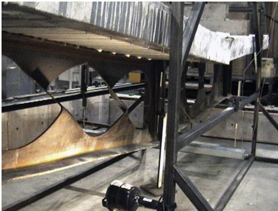
Figura 52 - Fallo por exceder material del alma
