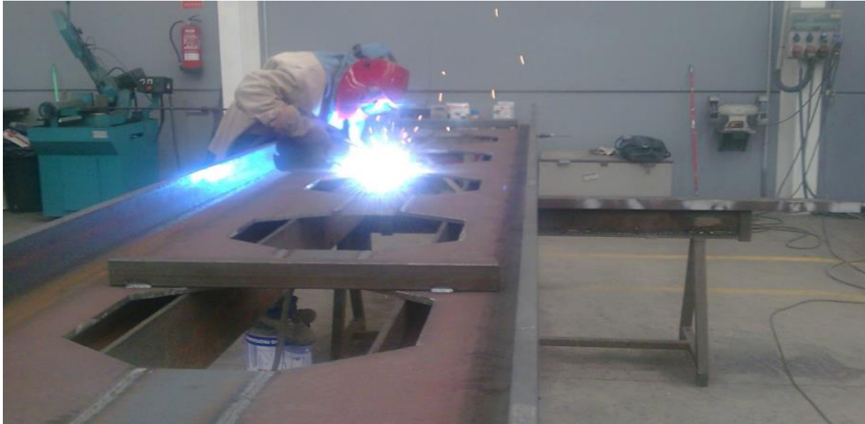
Figura 27 – Retoque de defecto
