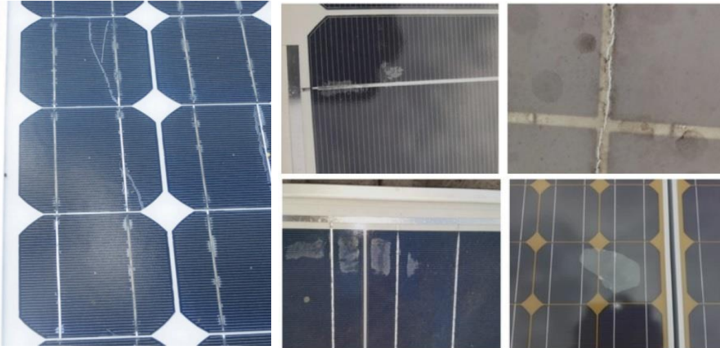
Figura 3.2: Fotografías del efecto de la delaminación de las células en un panel fotovoltaico (MonoSolar, 2021) (Dsisolar, 2021)
