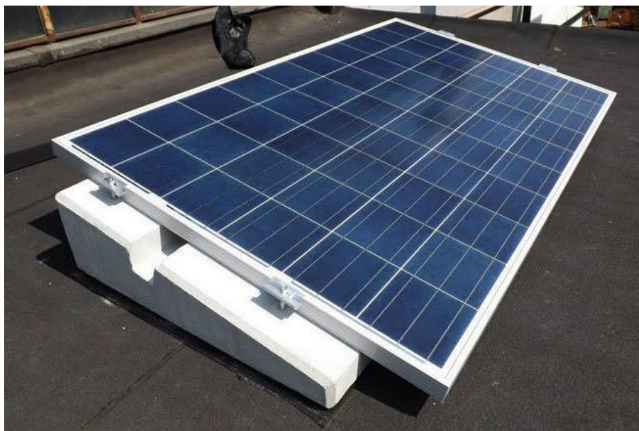
Figura 2.6: Fotografía de una instalación fotovoltaica de Paneles de Silicio Policristalino (Acuatro, 2021)
