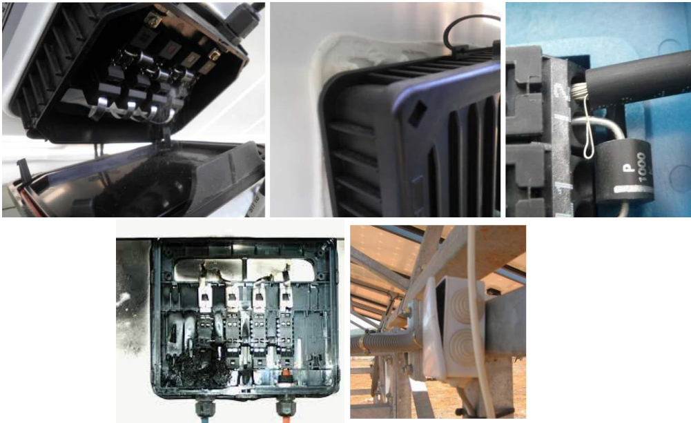
Figura 3.8: Fotografías de diferentes cajas de conexiones, abiertas, con problemas de estanqueidad y con problemas en las interconexiones. (CambioEnergético, 2021) (F.Martínez Moreno, 2013)
