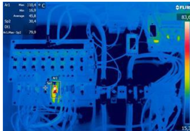
Figura 3.27: Fotografía tomada de un fusible dañado sobrecalentado. (Photovoltaic, 2018)
