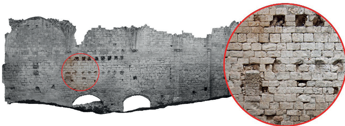
Figura 234. El nivel de detalle de los alzados generados permite detectar cualquier desperfecto o patología que exista sobre la superficie. Fuente: elaboración propia
