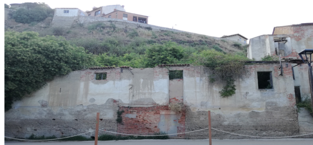
Volúmen C, desde la Calle del Rollo. Únicamente conserva ésta fachada, la trasera y techumbre han cedido. Fuente propia.
