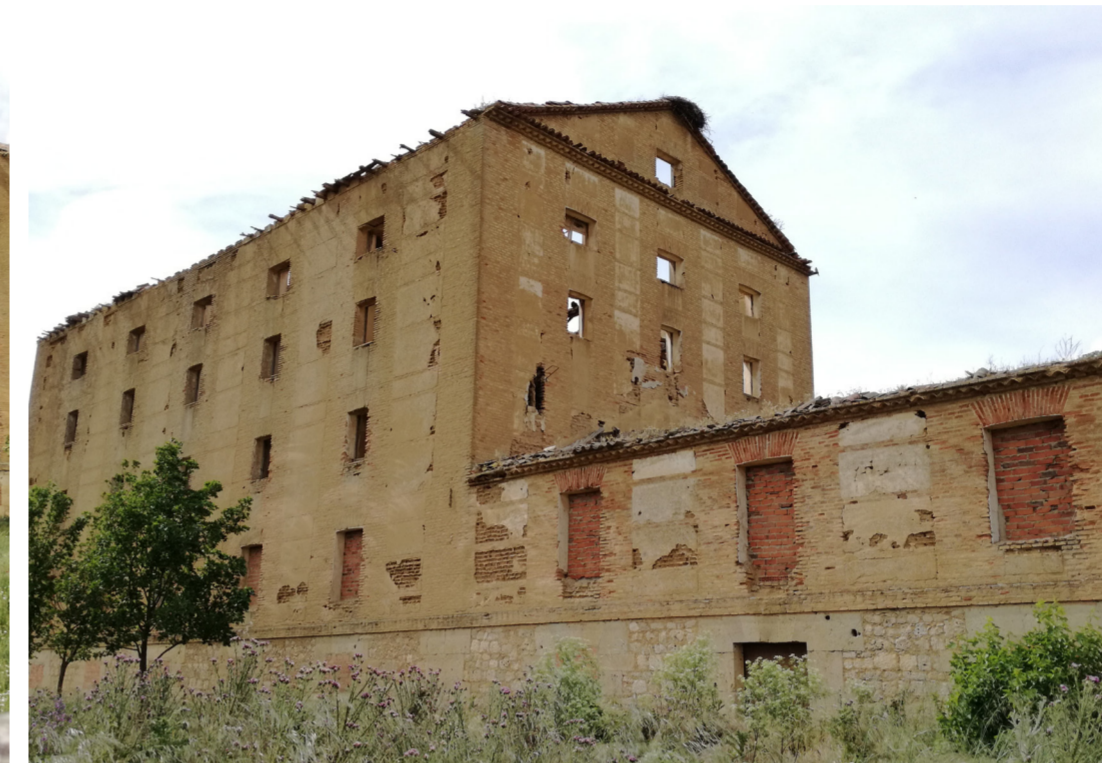
Fachada sur del conjunto, con el cuerpo de fábrica junto al cuerpo este. Se encuentra en un avanzado estado de deterioro, sin las cubiertas y desprendimientos. Fuente propia.
