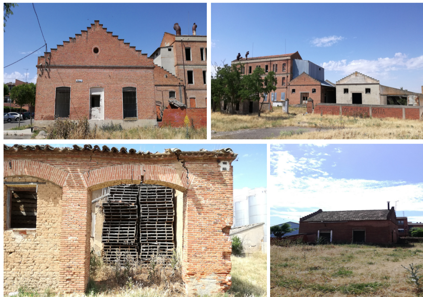
Ejemplos de algunos volúmenes a modo de almacenes anexos al cuerpo de fábrica. Se observa que el empleo del ladrillo visto es abusivo, incluso entre aquellos cuerpos más humildes del conjunto. El primero (arriba a la izquierda) parece que sería unas oficinas o vivienda, ya que cuenta con un interior compartimentado; los de la izquierda, el primero de ellos en un principio formaba el almacén de productos ya finalizados, pero llegado un momento se decide adherir a la zona de producción e incorporar un nuevo almacén, el de su derecha, revocado de blanco. Fuente propia.
