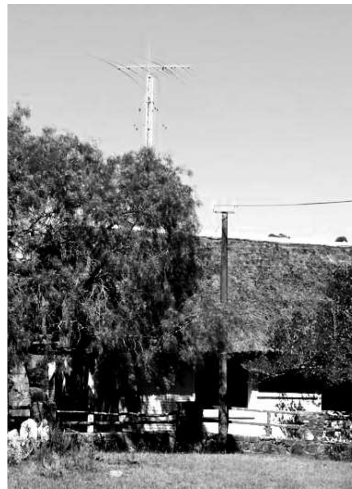
Instalaciones de electricidad, teléfono y TV. (Fuente: Villa Serrana SA).
