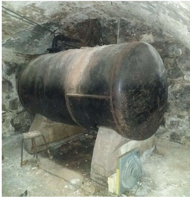
Figura 13 - Cuarto del tanque de gasoil al fondo de la primera nave. Fuente: Producción propia.
