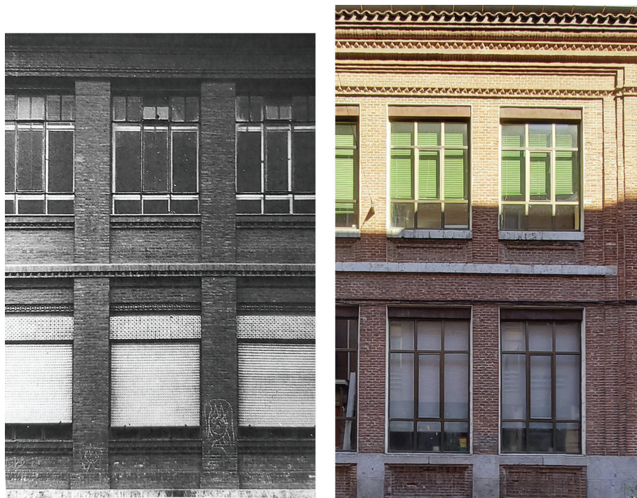
Fig. 7. Detalle de alteraciones de fachadas: en el Gonzalo de Córdoba (izquierda), en los huecos superiores aún perduraban las delgadas carpinterías originales de acero y las celosías caladas en los dinteles, pero se han ido perdiendo en favor de las de aluminio con cajonera de persiana oculta por azulejo; en la Escuela Normal (derecha), los dinteles se sustituyeron por vulgares chapas perforadas y las carpinterías ya son todas de aluminio color bronce. (Fuente: Baldellou y Capitel, 1995: 52; Fotografía de Rodrigo Almonacid Canseco tomada en 2022).
