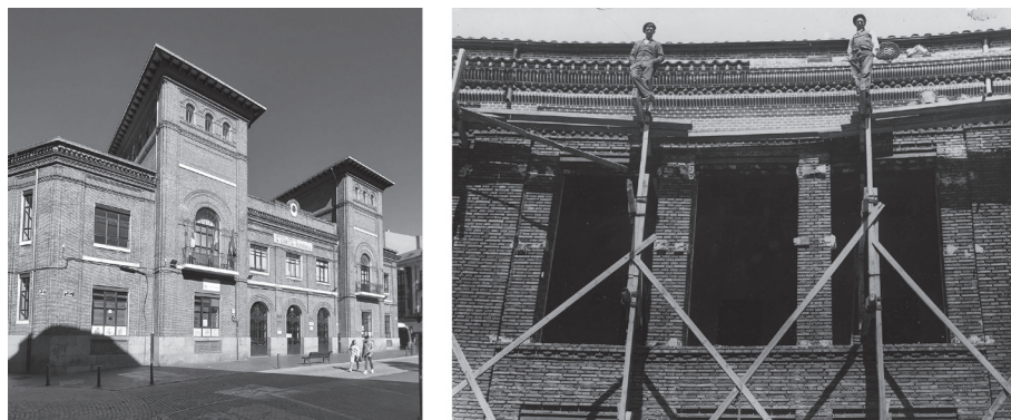
Fig. 11. Escuela Normal de Valladolid realizada por Antonio Flórez: fotografía reciente de la fachada principal (izquierda) y de la construcción de un aula en el patio interior (derecha) (Fuente: autor; Archivo General de la Administración).
