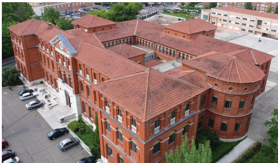
Fig. 10. Restauración de fachadas del Instituto Zorrilla en 2006. Véase la protección del frontón y las impostas con chapa de cinc, para evitar el deterioro de las fábricas de piedra caliza y de ladrillo (Fuente: Fotografía del autor).
