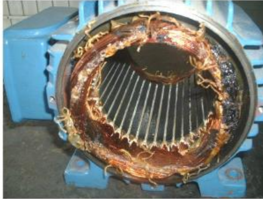
Figura 4.1. Motor dañado por sobrecargas térmicas. [14]
