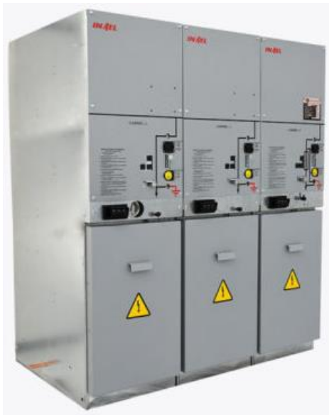
Fig. 53. Celdas de media tensión aisladas en SF 6 .
