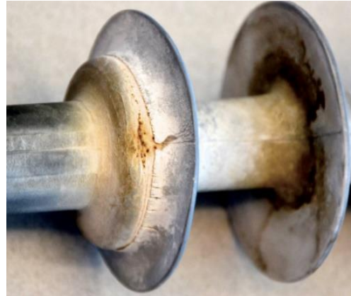
Fig. 8. Aislador polimérico deteriorado por descargas de corona. [26]
