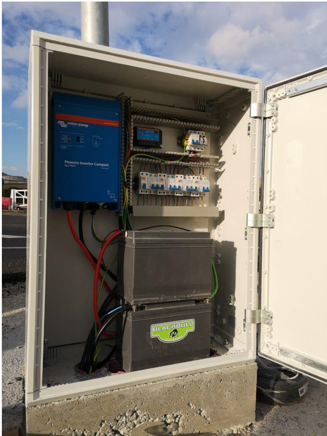
Figura 3.3: Instalación aislada de Inversor Victron Phoenix y baterías de gel.
