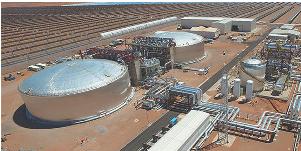
Figura 5.14: Central termosolar con almacenamiento de energía térmica.
