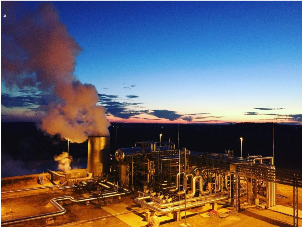
Figura 3.4: Central geotérmica de Velika Ciglena.
