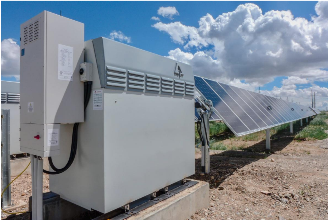
Figura 5.18: Batería de flujo de Vanadio de VoltStorage.
