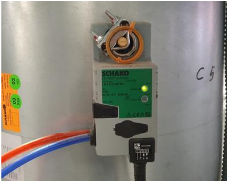
Figura 3.22. Compuerta reguladora Schako instalada en la UCI preparada para biocontención.
