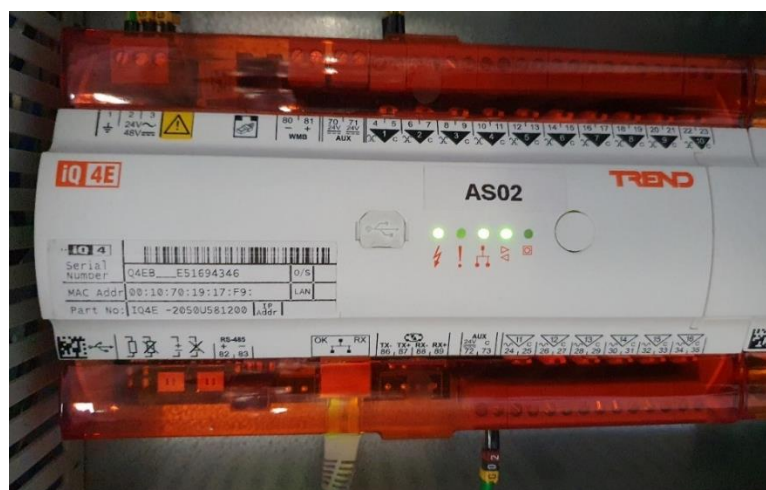
Figura 3.9. Autómata programable IQ4E instalado en la UCI preparada para biocontención. Imagen cortesía de [15].
