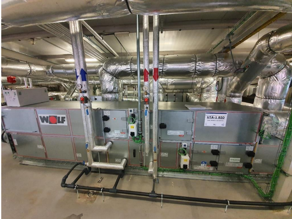
Figura 3.5. UTA del HURH correspondiente a la zona común de la UCI preparada para biocontención.
