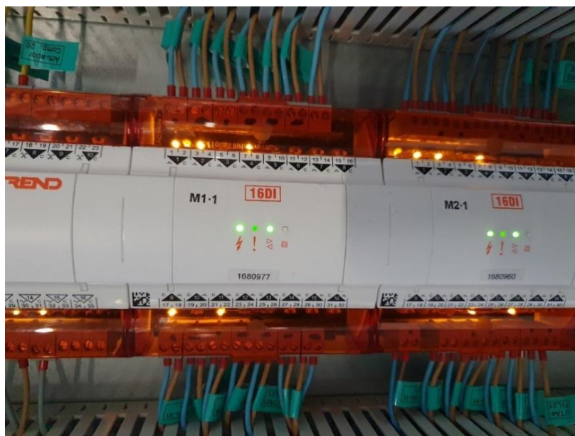
Figura 3.12. Módulo de expansión de 16 entradas digitales instalado.
