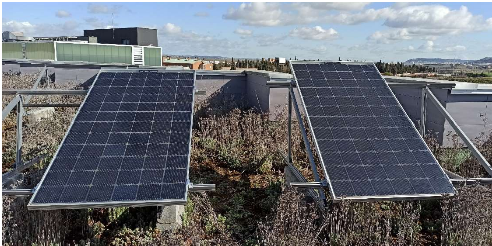
Figura 11. Fotografía de los módulos utilizados en la instalación.
