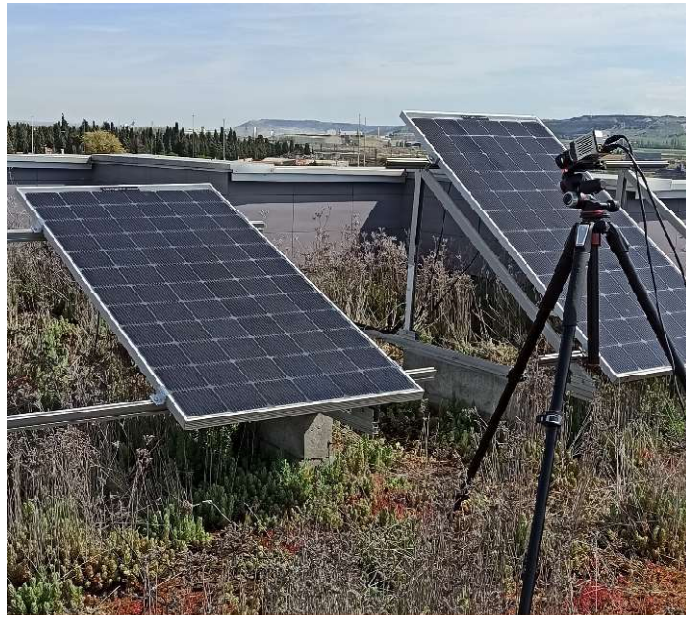
Figura 9. Pruebas de luminiscencia en la instalación.
