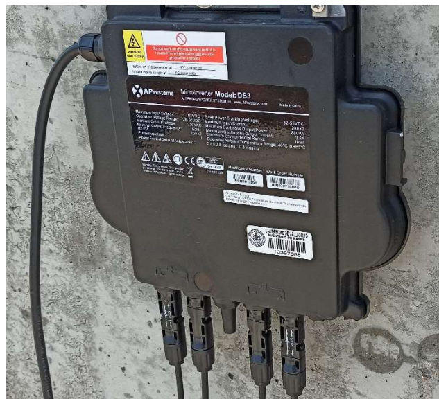
Figura 15. Imagen del inversor en la instalación.
