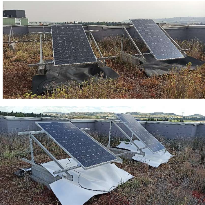
Figura 40. Instalación con superficie oscura (superior) y blanca (inferior).
