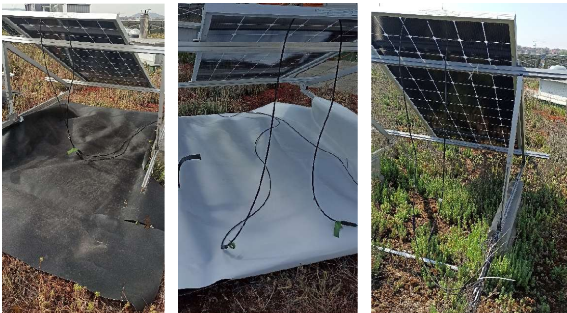
Figura 41. Instalación con diversas superficies: oscura, blanca y hierba natural.
