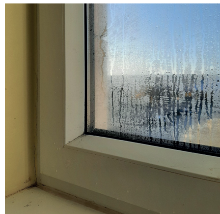
Figura 1: Condensación superficial sobre ventana.
