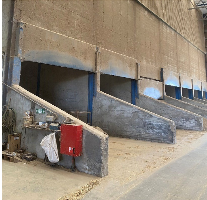
Figura 28. Cubículos de Almacenamiento
