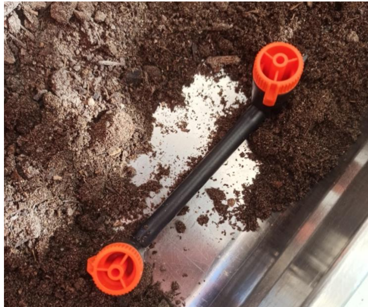
Figura 74. Conexiones de tubería y goteros.
