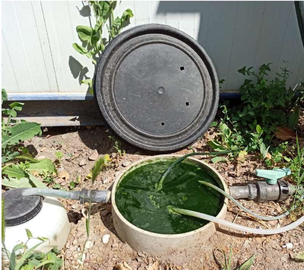
Ilustración 8: Sedimentador de la planta piloto [26]
