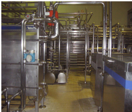
FOTO N° 24 SALA DE PASTEURIZADO. SISTEMA DE TUBOS
