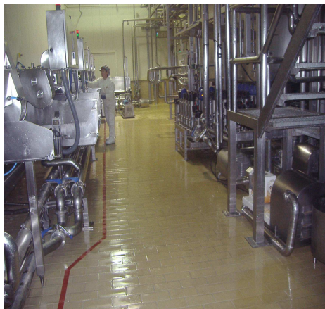
FOTO N° 20: SALA DE PROCESOS
