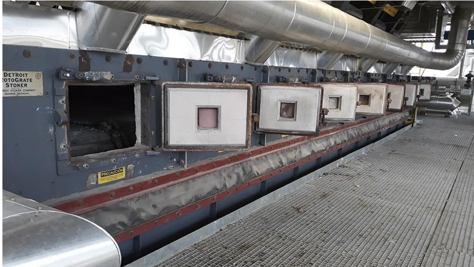
Figura 37. Parte inferior de la cámara de combustión de la caldera de biomasa de Forestalia en Cubillos de Sil, con los registros de acceso al cenicero de fondo [30].
