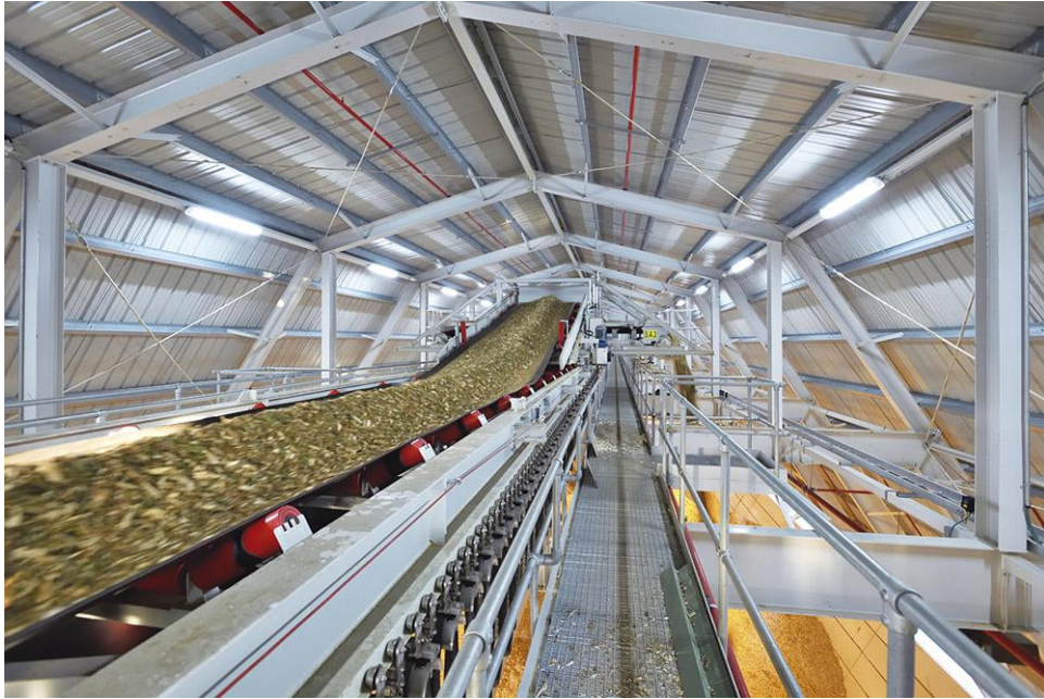
Figura 35. Vista de las cintas de alimentación de biomasa forestal hacia la caldera de la planta de Forestalia [30].
