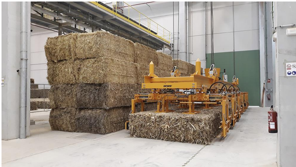
Figura 36. Dispositivos para mover las balas de paja agrícola previo a su introducción en la caldera de la planta de Forestalia en Cubillos de Sil [30].
