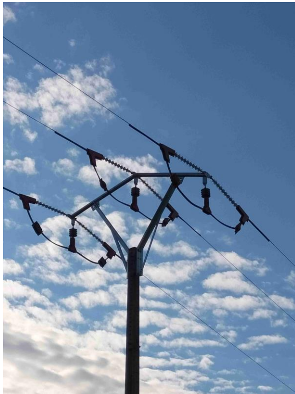
Ilustración 27. Cruceta tipo bóveda con aisladores en amarre corregido.
