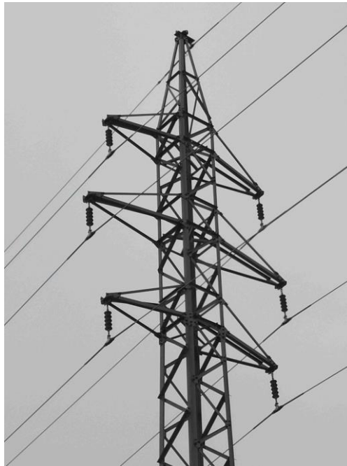
Ilustración 3. Apoyo de doble circuito.
