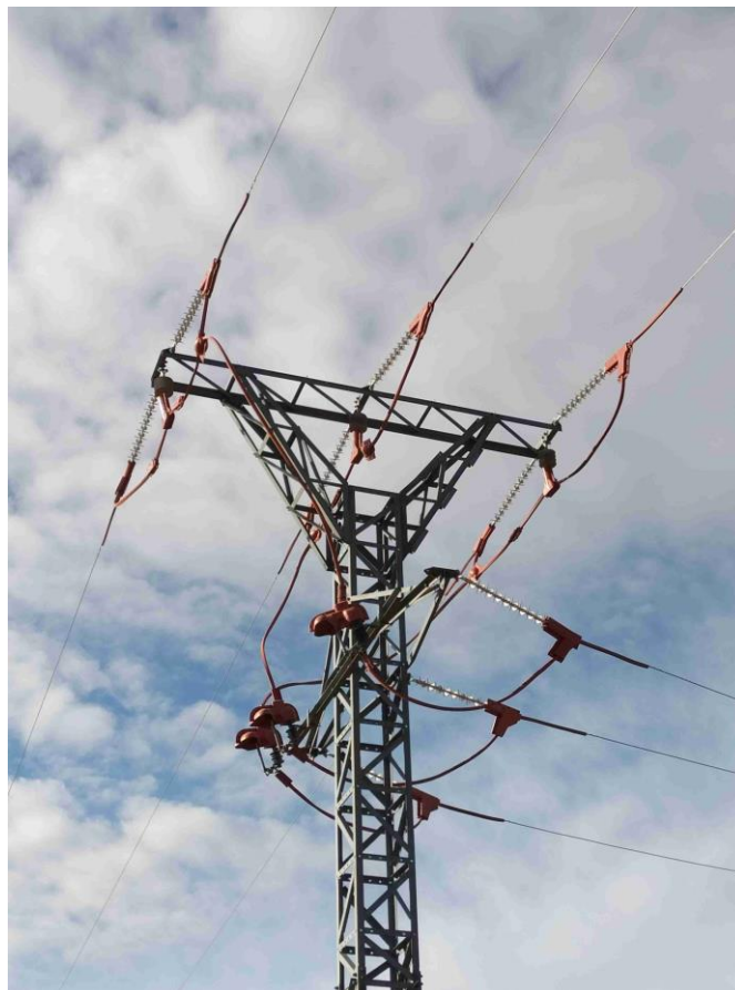
Ilustración 29. Corrección de apoyo con cruceta tipo bóveda en celosía y aisladores en amarre con fusibles XS y derivación corregidos.
