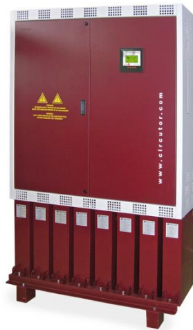
Figura 12. Batería de condensadores
