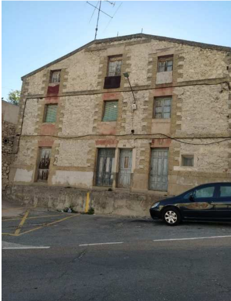
Fotografía de una vivienda de protección pública de la calle Juan de Rojas 1 del pueblo de Cuellar 108
