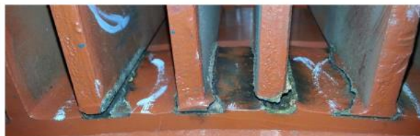
Figura 5: Grietas y separación de la unión barra-anillo en un rotor de cobre soldado (Dong Kim, y otros, 2015).
