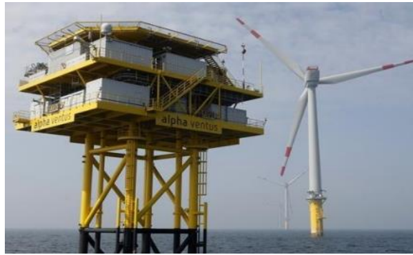
Figura 48. Subestación eléctrica offshore.
