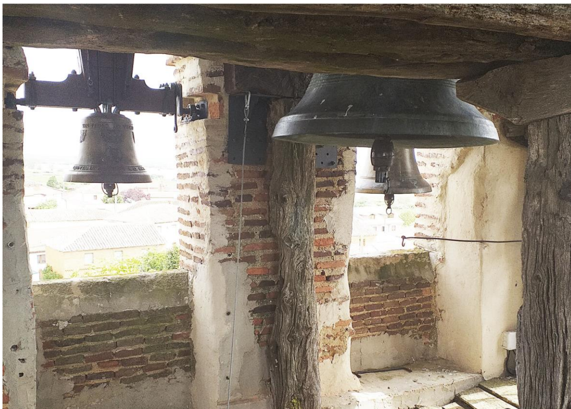
Fig. 10 Campanas suspendidas en vanos parcialmente tapiados con antepechos de ladrillo con remate pétreo. Dentro, otra campana mayor sobre el soporte de madera. Iglesia de San Pedro, Villota del Páramo. Imagen del autor.
