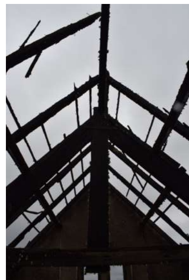
“Bajocubierta” de la estación de Losacio-San Martín después de su incendio, provocado por un rayo (Imagen propia, 2021).
