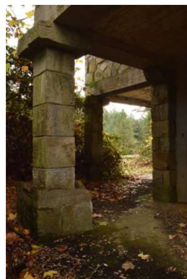
Detalle del pilar de sillares de piedra del edificio de viajeros de la estación de Robledo (Imagen propia, 2022).
