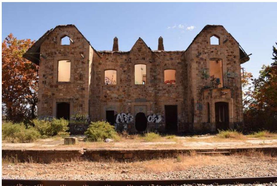
Imagen de la estación de Pobladura-Las Torres de Aliste después del incendio forestal donde perdió su cubierta. (Imagen propia, 2022)
