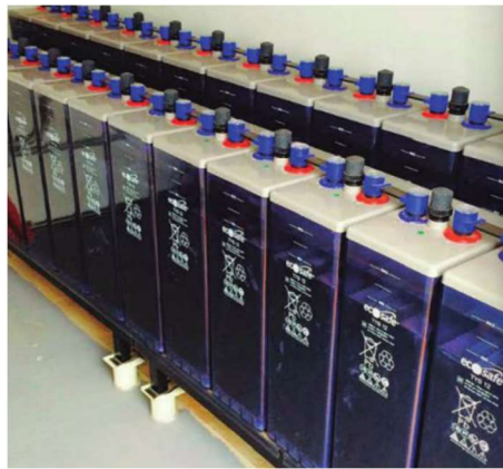
Figura 16: Sistema de acumulación de baterías estacionarias. Fuente: Cantos Serrano (2016).
