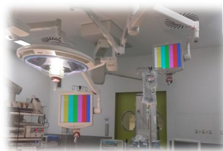
Pantallas móviles en quirófano inteligente. (Realización propia).
